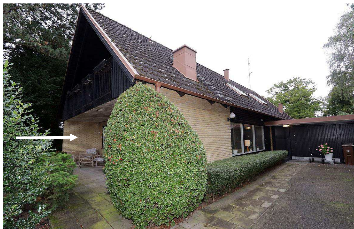
Figur 5. Gaveln mot gatan med en krossad fönsterruta.
