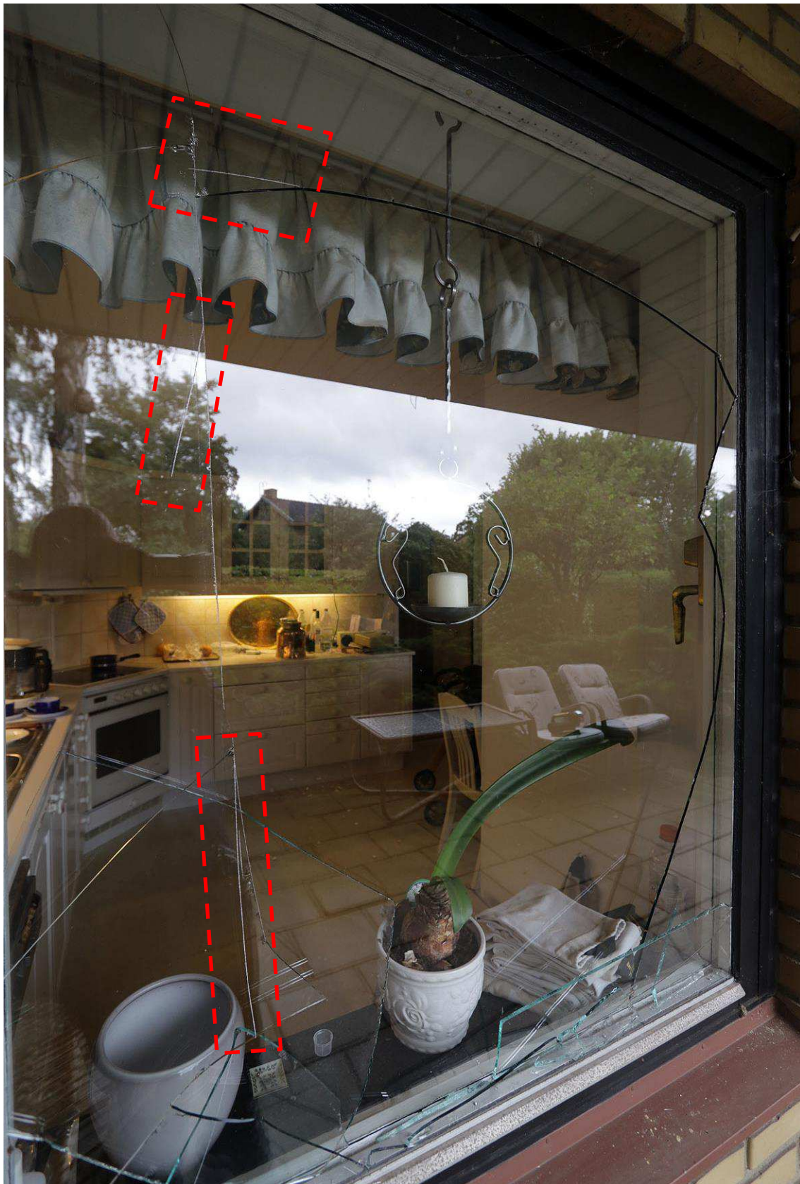
Figur 8. Markeringarna visar rispor på den yttre krossade rutan.
